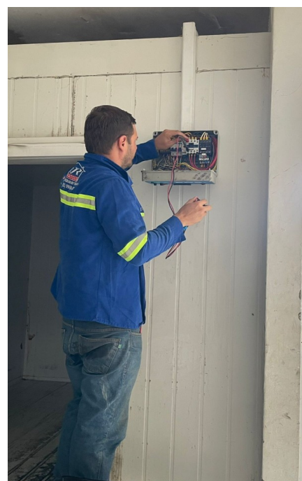
Figura 3: caixa elétrica com oscilação de energia
