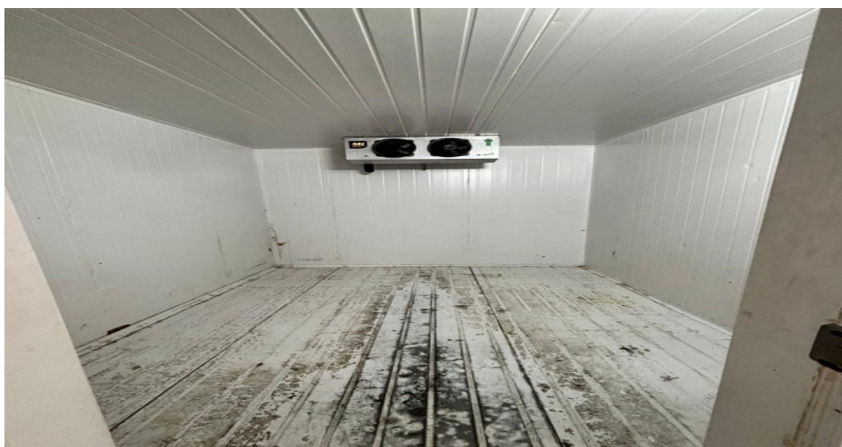
Figura 8: ventiladores queimados devido a oscilação de energia
