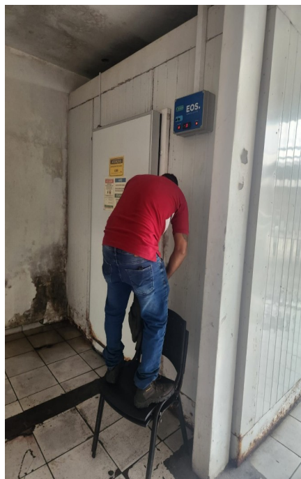
Figura 1: Porta em curto aquecendo
