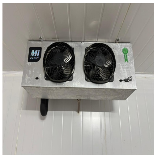
Figura 7: Ventiladores queimados devido a oscilação de energia
