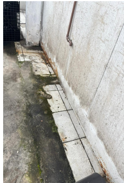
Figura 6: Imagem Lateral da câmara frigorífica
