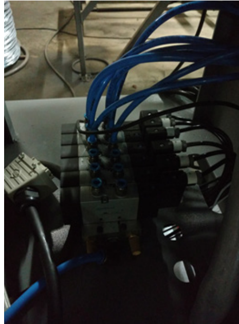
Fig 44 - Ilustração de parte dos cabos do comando pneumático conectados em seu suporte, presente no módulo 1.
