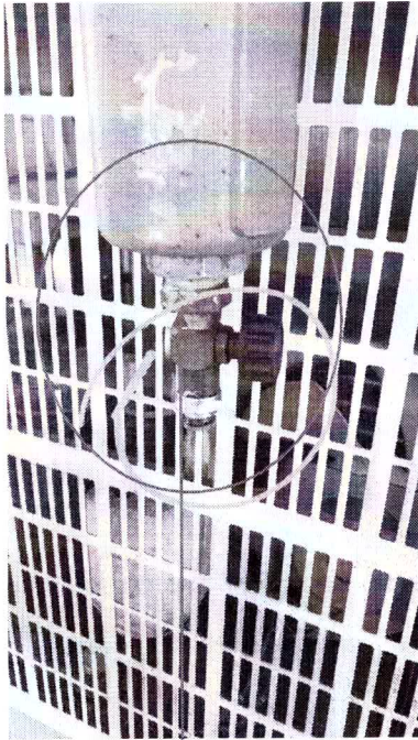
Instalação do Purgador Automático Temporizado
