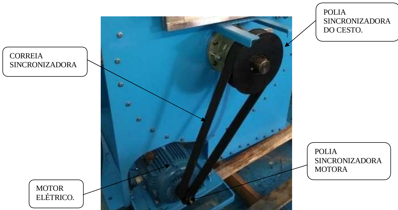
Foto: Sistema de Transmissão (sem proteções) olhando da área suja.
