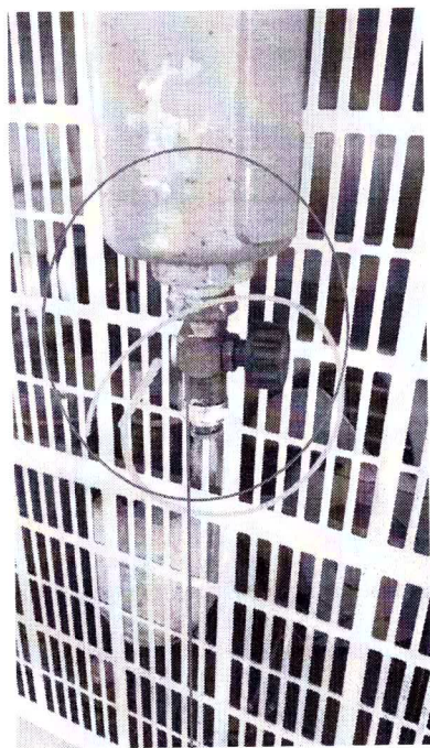
Instalação do Purgador Automático Temporizado
